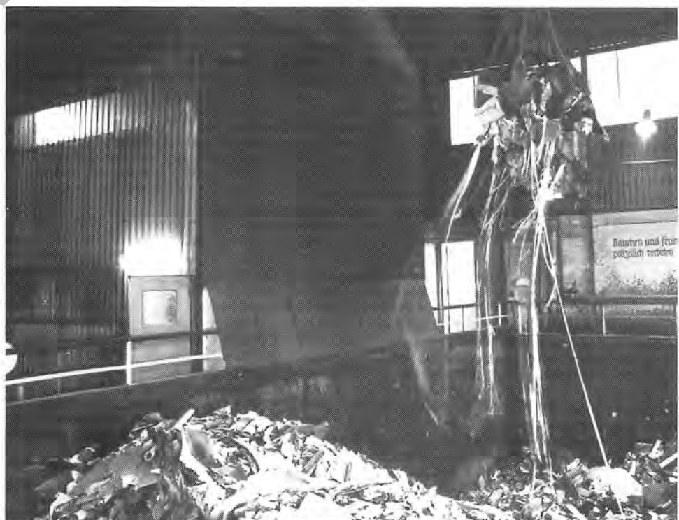
Vom Müllsilo kommen die brennbaren Abfälle in den Verbrennungsöfen.
