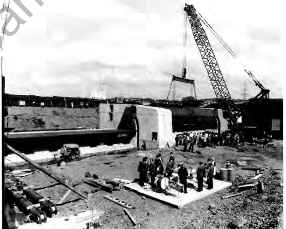
Das Wehr des Kemnader Stausees entsteht. Beim Einsetzen der Stauklappen wurde kürzlich ein kleines „Richtfest“ mit zahlreicher Prominenz gefeiert.
