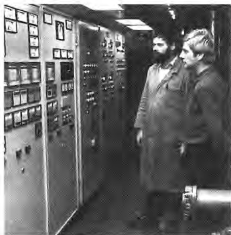
Im Kraftwerk M 3. Der Betriebsablauf muß ständig überwacht werden. Schichtleiter Kamill Göpp (links) mit Mitarbeiter Helmut Pletsch.
