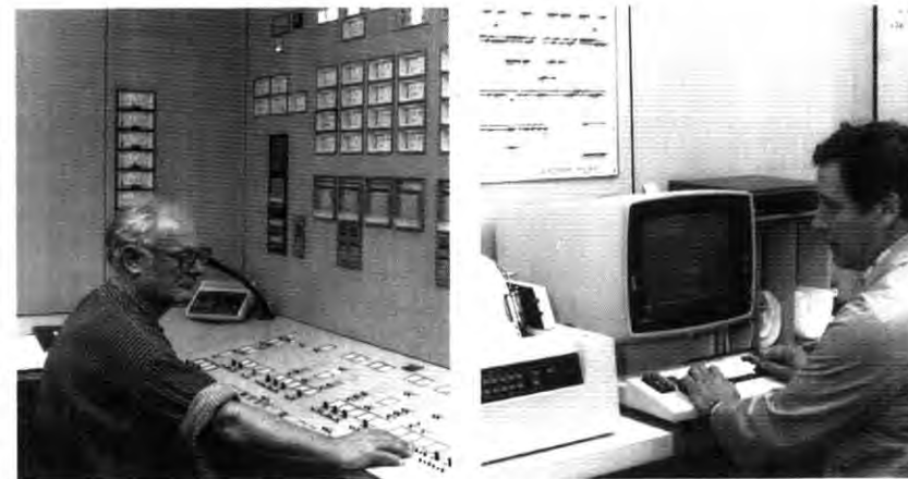
Mitarbeiter Günther Loitz am Leitstand von Kessel II bei der Überprüfung der Betriebsfunktionen. Die wirtschaftlichste Fahrweise der Energieanlagen wird durch ein Optimierungsprogramm ermittelt; auf dem Bild rechts am Datensichtgerät Mitarbeiter Gerhard Thiel.
