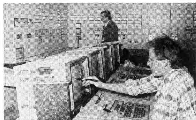
Leitstelle: High-Tech für saubere Schornsteine.
