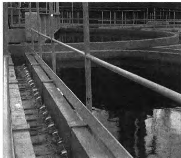
Kühlwasser: Gereinigtes Mainwasser statt Trinkwasser
