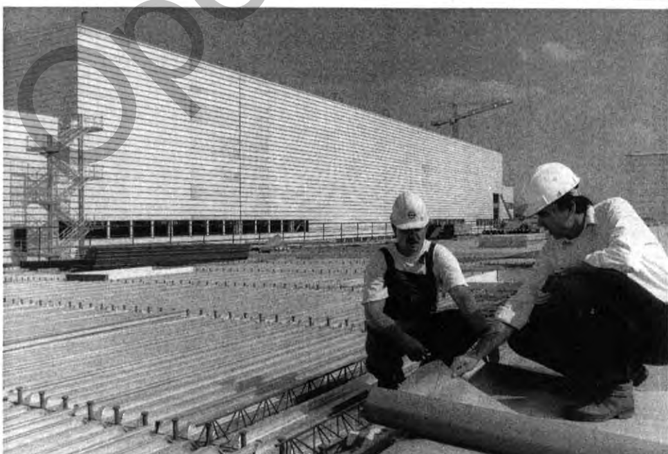
Die Außenarbeiten am Bau des neuen Werks in Eisenach sind jetzt abgeschlossen. Mit Hochdruck arbeiten die beteiligten
