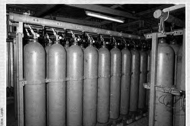
Flaschen: Über vier Tonnen Löschmittel lagern hier noch
