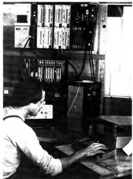
Mitarbeiter H. Kirsch beim Prüfen einer IPC-Steuerung.
